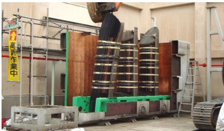
大型変圧器（トランス）
