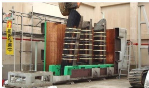
大型変圧器（トランス）
